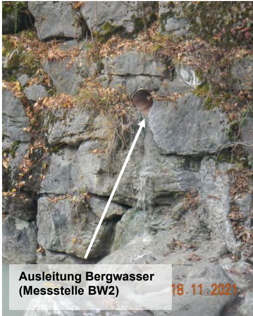
Messstelle BW2 (Bergwasser 2)
